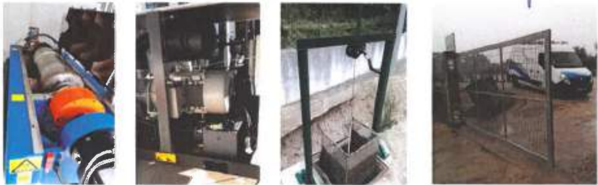
Figura 13 - Remoderação de ETAR em Montemor-o-Velho – Centrifuga da ETAR de Arazede, Compressor da ETAR de Licesa, Cesto de gradatões da ETAR da Portela e portão da ETAR da Crotaphela
