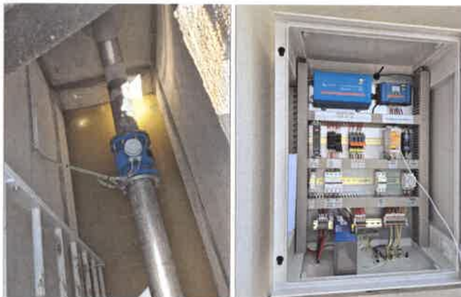
Figura 12 - Caudalímetro instalado e quadro elétrico
