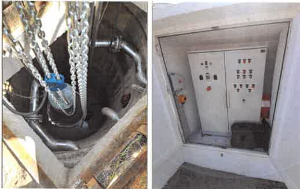
Figura 13 - Interior do poço de bombagem da EEAR da ZI e Quadro elétrico da EEAR da Rua dos Moliceiros
